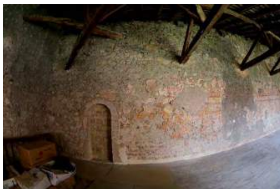
3 - Porte condamnée à l'étage de la galerie ouest du cloître ornée de peintures murales (cl. G. Danet)
