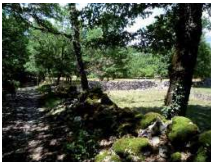
N° 42 - Les prés entourés de murets de pierres sèches en mauvais état (cl. G.-H. Bailly)
